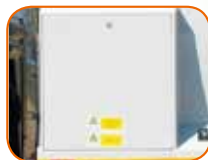
9 Panneau électrique centralisé au sein de l'armoire étanche facilement accessible
